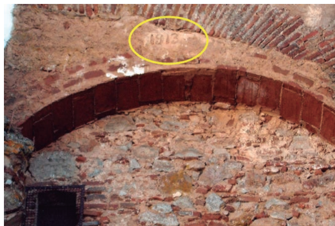
Figura 2 - No alçado lateral Norte do antigo Convento de S. Francisco, hoje a “creche”, está inscrita a data de 1913, ano em que, resultado de obras então polémicas, ocorreu a demolição de parte da sacristia da igreja e o consequente alargamento da via.
