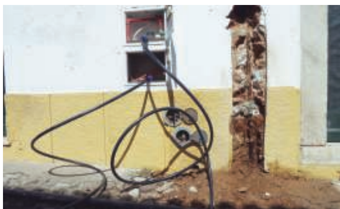
Abastecimento de água provisório e ramal em tubo galvanizado “apodrecido”
