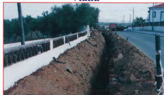
Pluviais da E.N. 257 Alcáçovas
