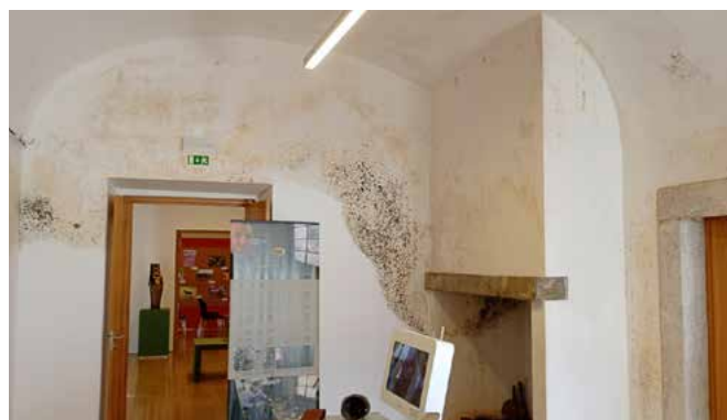
Falta de manutenção tem provocado danos significativos nos edifícios
